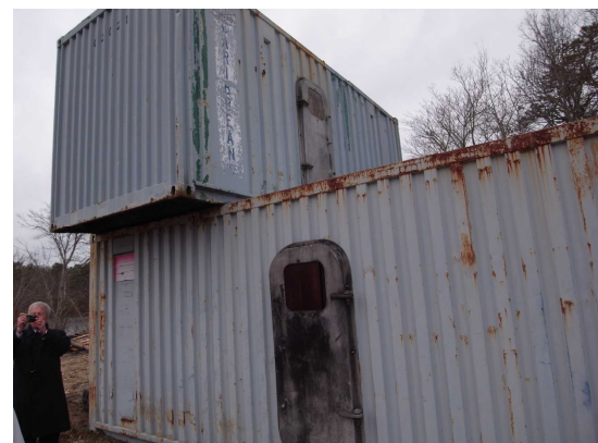
消火訓練コンテナ
